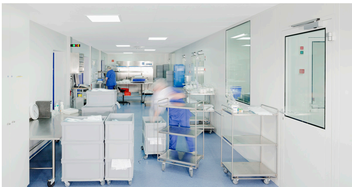
Pharma Labor-Vorbereitung, Greven, Germany
